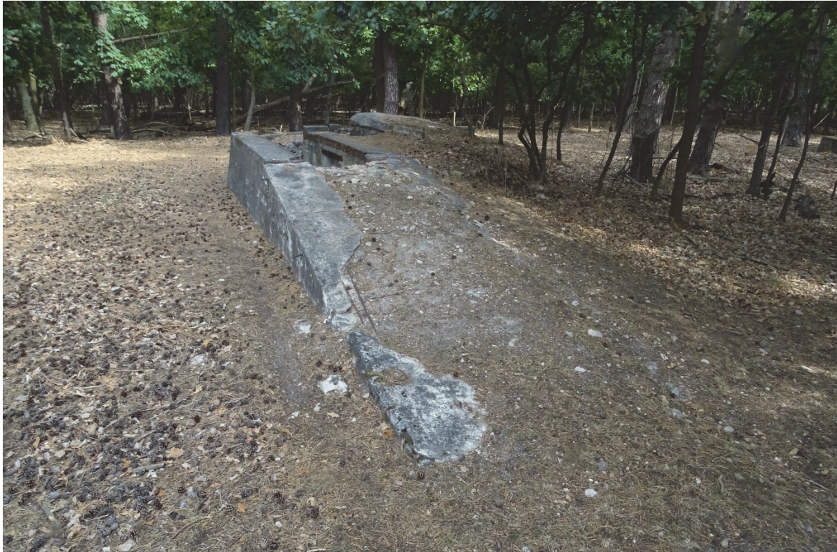
Juli 2022 - Fundamentreste des ehemaligen Sendemastes sind noch vorhanden © Lutz Essers mit freundlicher Genehmigung der Bundesnetzagentur
