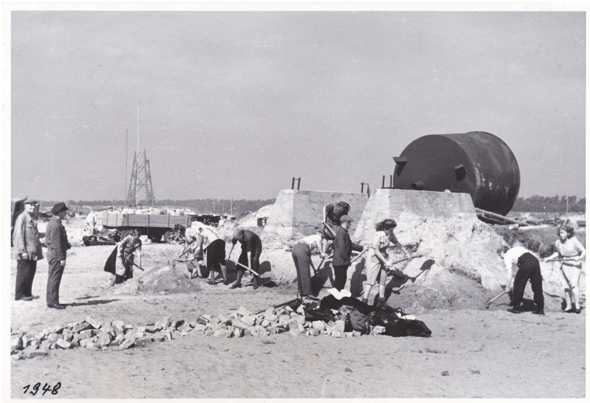
1948 - Der neue Flughafen wird gebaut. Im Hintergrund ist noch der Rest des demontierten Sendemastes kurz vor der Sprengung erkennbar. © Archiv Michael Grimm & Postmaxe
